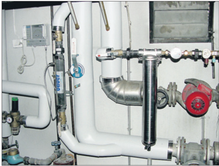
Bauer -vedenkäsittelylaite sekä suodatin asennettuna lämmitysvesiputkistoon.
