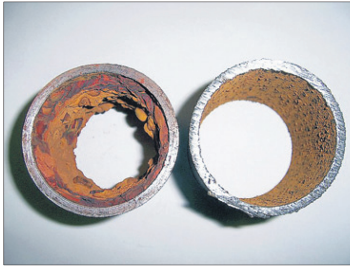
Kuva putkesta ennen Bauer -vedenkäsittelylaitteen asennusta ja noin vuosi sen jälkeen.
