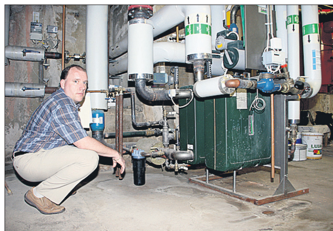
Rauhankadun lämmönjakokeskus on näyttävä systeemi. Vedenkäsittelylaite on lämmönjakokeskuksen putkiston osana. Laitteistoa esittelemässä isännöitsijä Juha Ranta.
