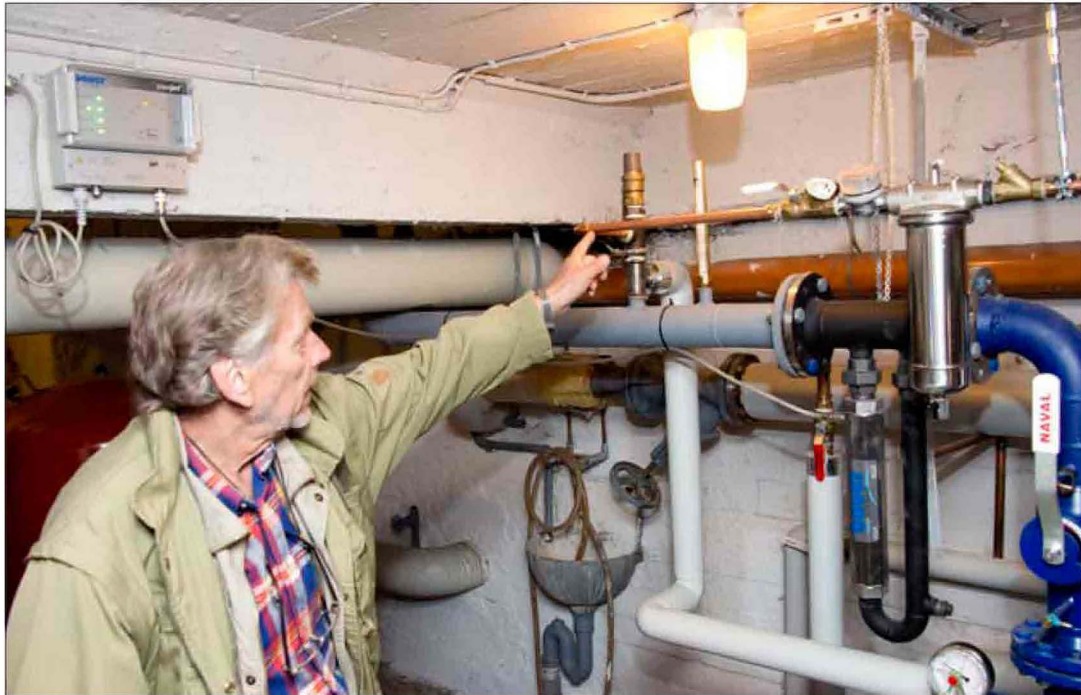
Tekninen isännöitsijä Matti Wuoristo pyrkii käymään joka päivä taloyhtiön lämmönjakuhuoneessa. Kupariputkea pitkin lämmitysjärjestelmän vesi kiertää suodattimen läpi. Suodatin on kirkaassa patruunapessässä kuvan oikeassa yläkulmassa.
