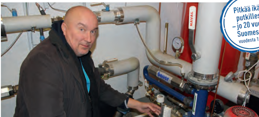
Kiinteistöpäällikkö Toni Helinin mukaan Bauerin vedenkäsittelyjärjestelmä sopii erinomaisesti Ekokompassi-sertifioituun järjestelmään.
