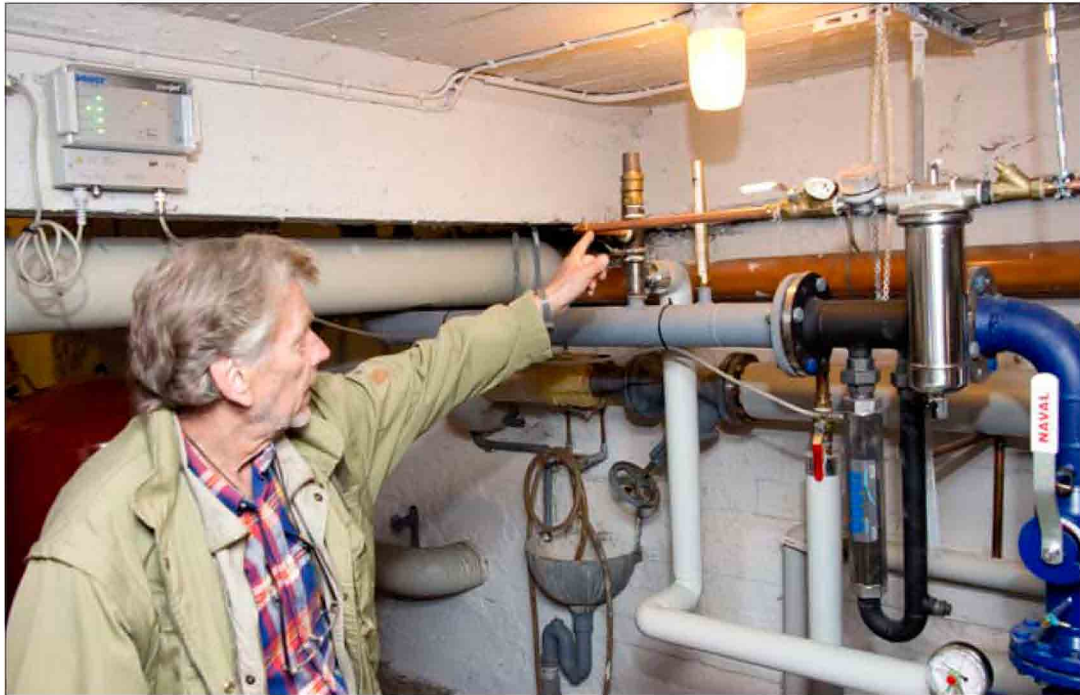
Tekninen isännöitsijä Matti Wuoristo pyrkii käymään joka päivä taloyhtiön lämmönjakuhuoneessa. Kupariputkea pitkin lämmitysjärjestelmän vesi kiertää suodattimen läpi. Suodatin on kirkkaassa patruunapessässä kuvan oikeassa yläkulmassa.
