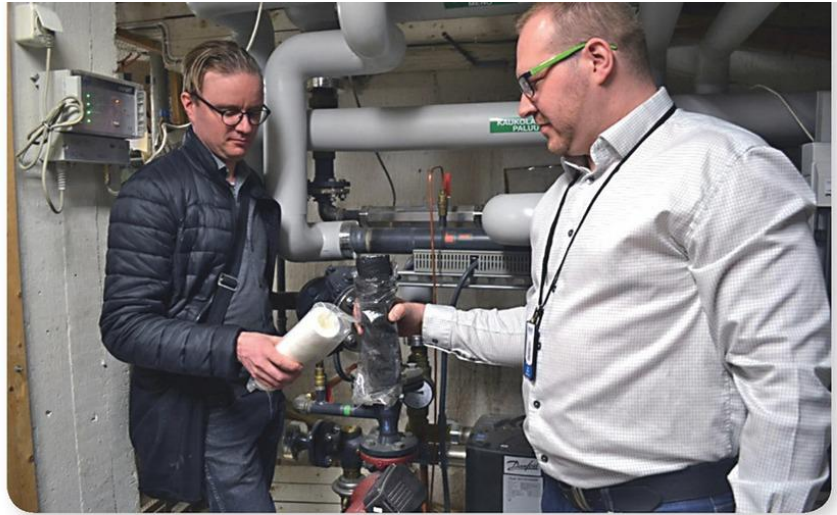
Mika Nieminen ja Sami Niemi tarkastelevat lämminvesijärjestelmän vanhaa ja uutta sivuvirtasuodattimen suodatinpatruunaa – vanha on melkoisen mustunut. Lämminvesijärjestelmässä patruuna on vaihdettava tietyin väliajoin, muuten Bauerin vedenkäsittelylaite on huoltovapaa.
